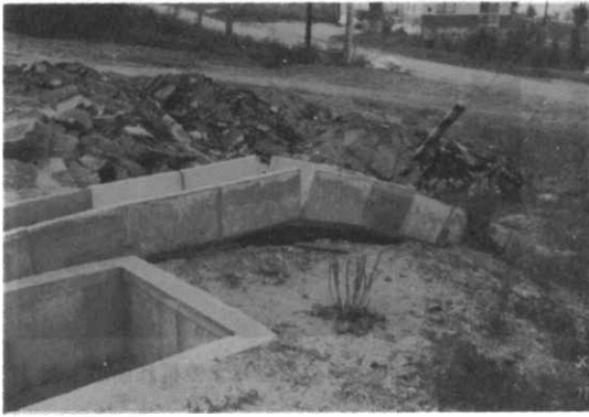
写真3 地盤の圧縮変動によりU字溝が字面より浮上ってアーチ状となった
