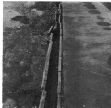
写真2 地盤の圧縮変動により押しつぶされたU字溝
