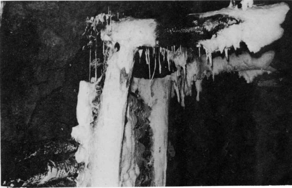
坑口から400 m付近の坑木に発生しているカビ。色は白またはごくうすい黄色で、綿アメといった感じである。
