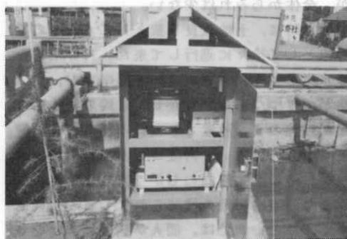
写真2 触針水位計制御記録部 橋波観測所
