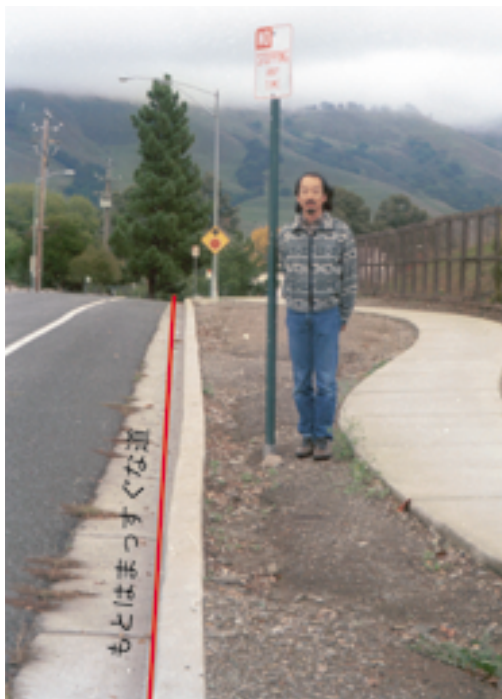
図1 ハイワード断層を巡検中の筆者。ハイワード断層は、地震時に急激に動くだけでなく、常に非常にゆっくり(毎年数mmから数cm程度)と滑っている(クリープ)ため、頻繁に補修をしているにもかかわらず、緑石が波打っているのが分かる。
