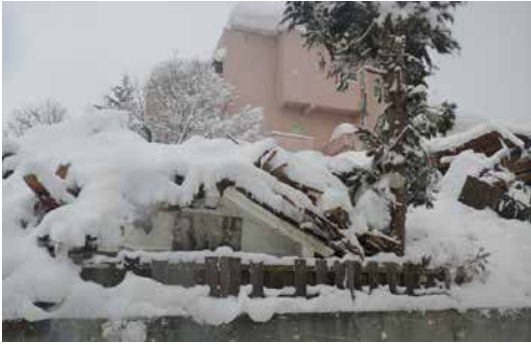
図6 空き家の倒壊(新潟県 2015年1月) Fig. 6 Houses destroyed by heavy snowfall on 2015.3 in Niigata Prefecture.
